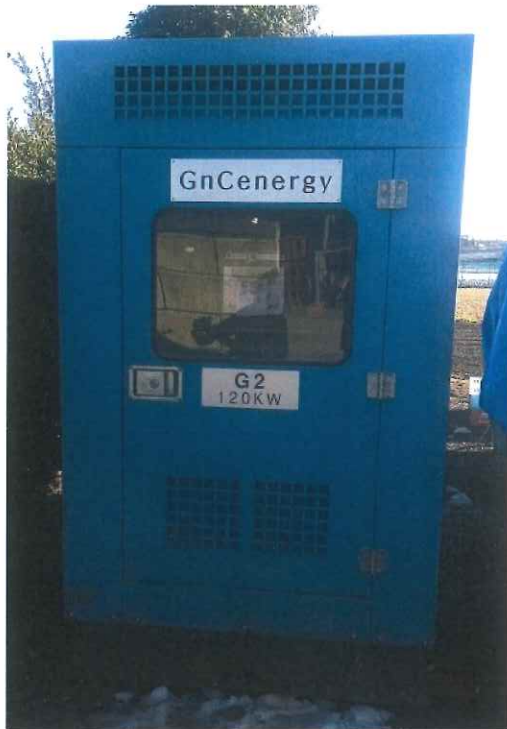
正面（操作盤側）
