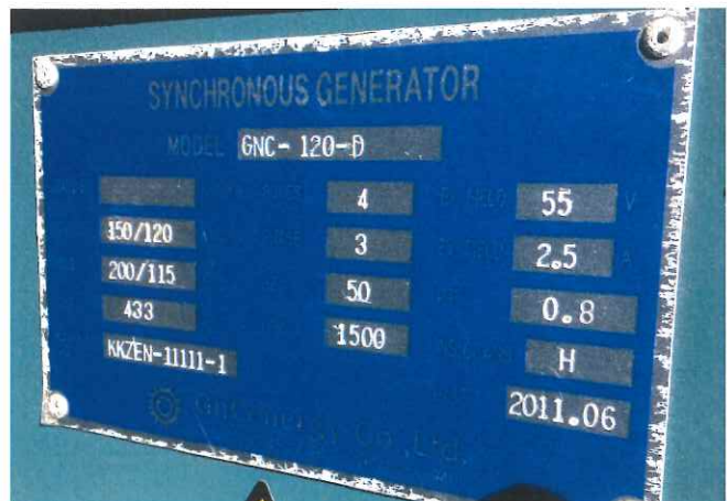
エンジン発電機ラベル
